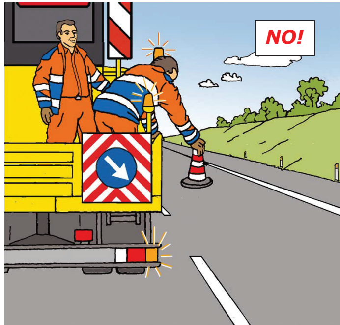
Figura 60 – Posizionamento dei coni o defleco: comportamento scorretto
